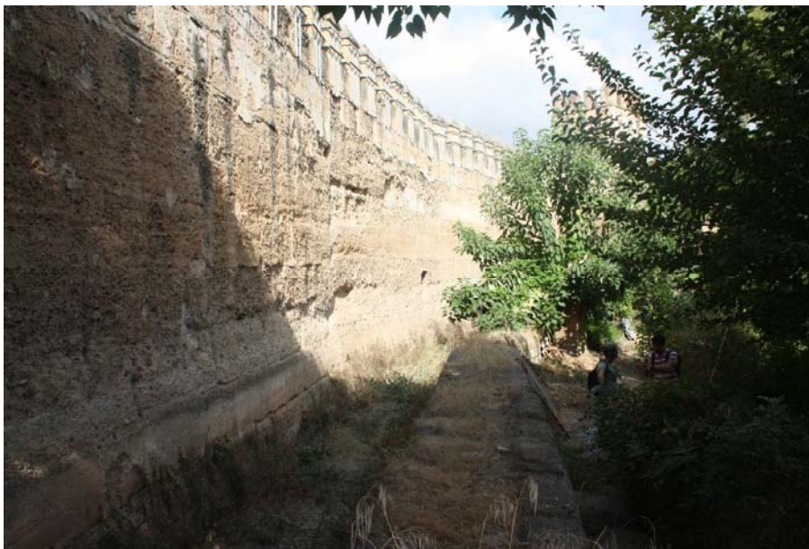
Muralla de la Macarena con pérdida de material en el espesor del muro superiora 50 cm en algunas zonas
